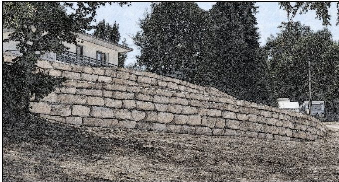
Exemples de soutènements non autorisés
