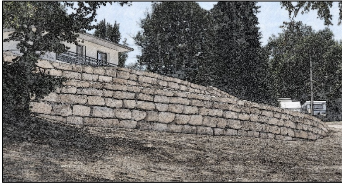
Exemples de soutènements non autorisés
